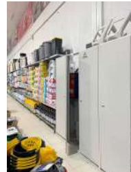
Wellkommen fuse box, 2026
